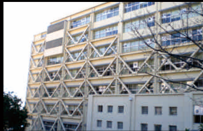
日本 神戶大學防震補強柱
